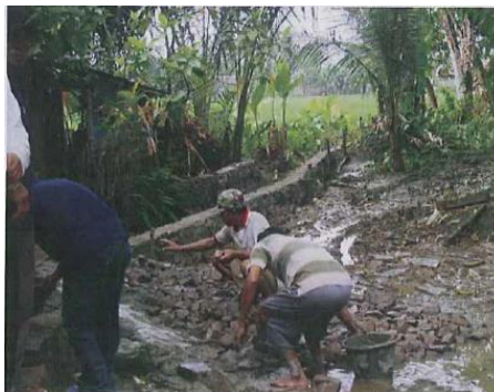
住民らが村に流れ込む水をせき止める水路を建設する様子（インドネシア・テルク村）
