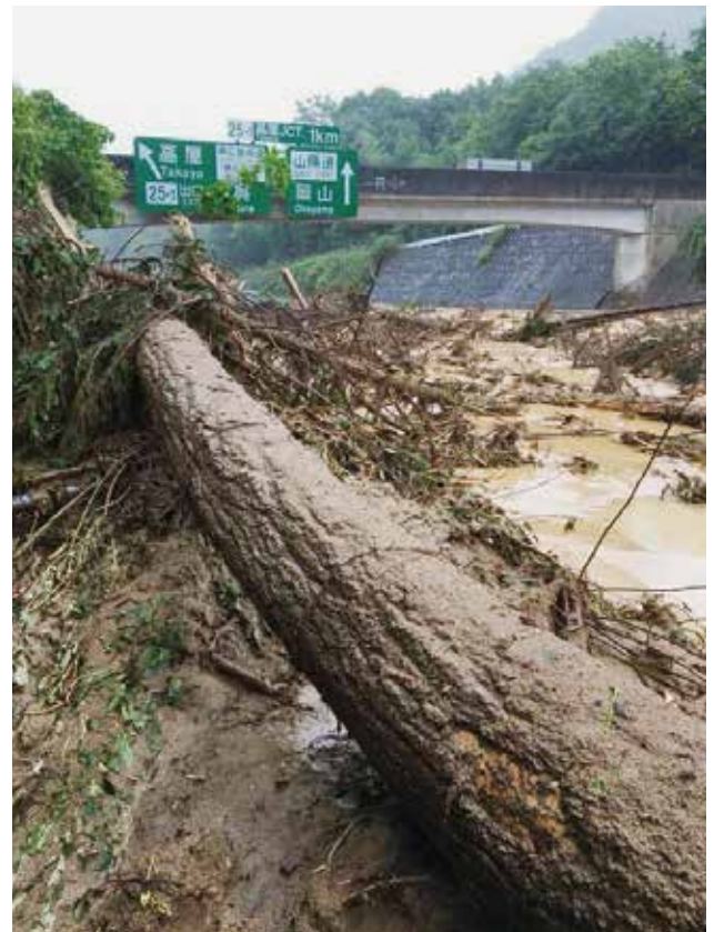
山陽道(東広島市高屋IC・JCT付近)の被害状況 (写真提供:国土交通省 中国地方整備局)
