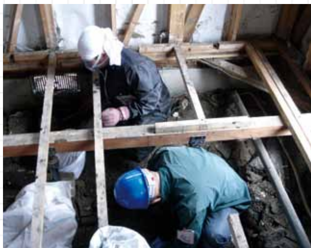
▲民家の床下の泥をかき出す
