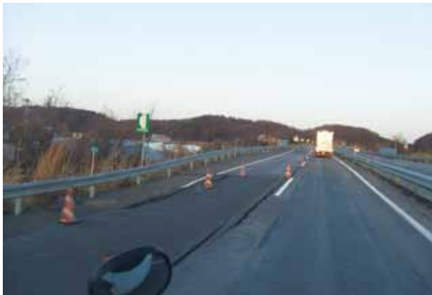
▲救援関係機関のみが利用できた高速道路は陥没が多く危険な状況（震災翌日）
