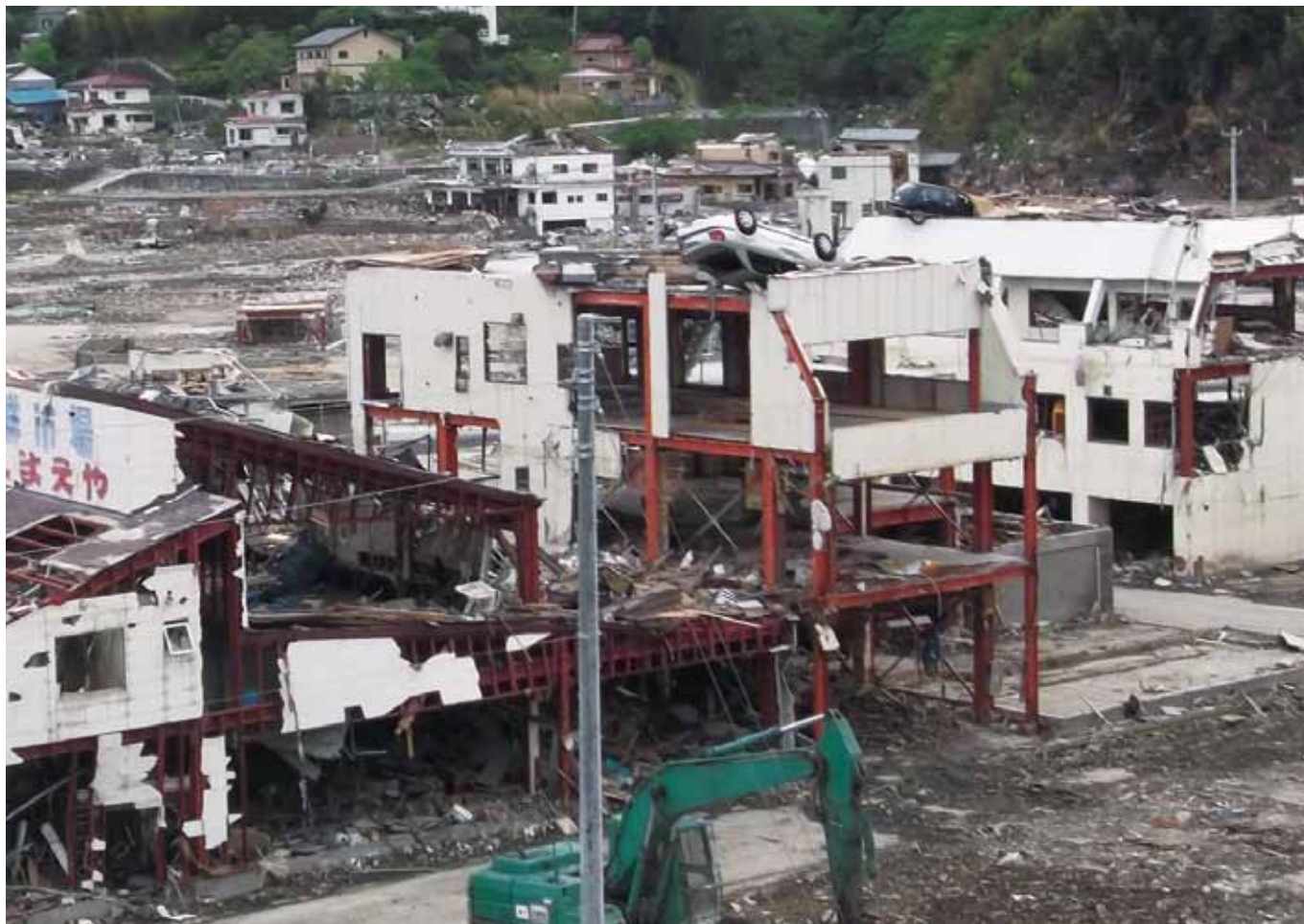
ビルをも飲み込む津波の破壊力（女川町）
