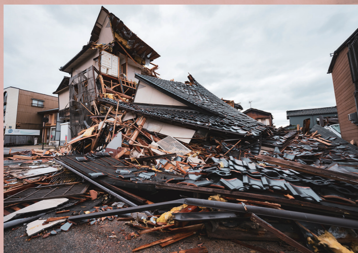
全壊した木造家屋 (輪島市)
