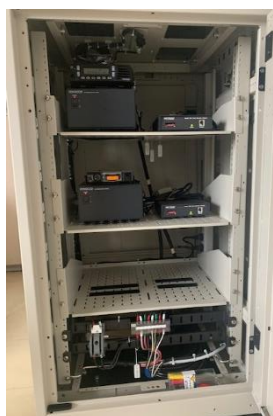
【屋上フロア 無線基地局】
