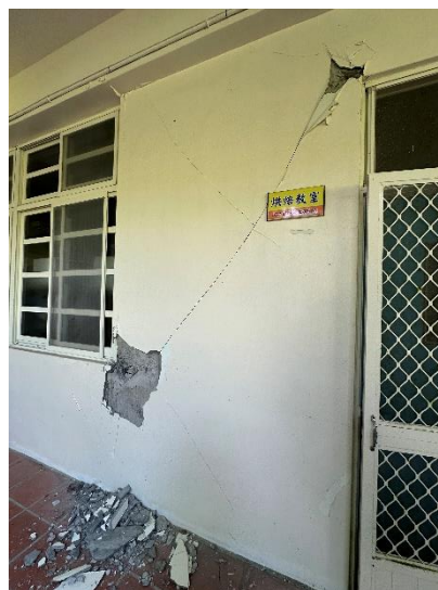
高さ3mまでひびが入る壁
